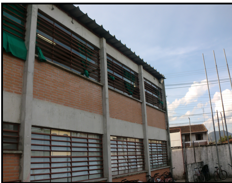
Figura 4 - Cobertura sem calha que não apresentou problemas de infiltrações
