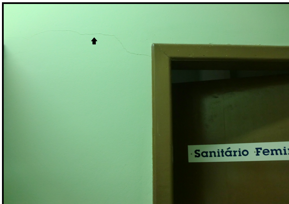
d) Figura 8 - Fissuras observadas nas edificações escolares
