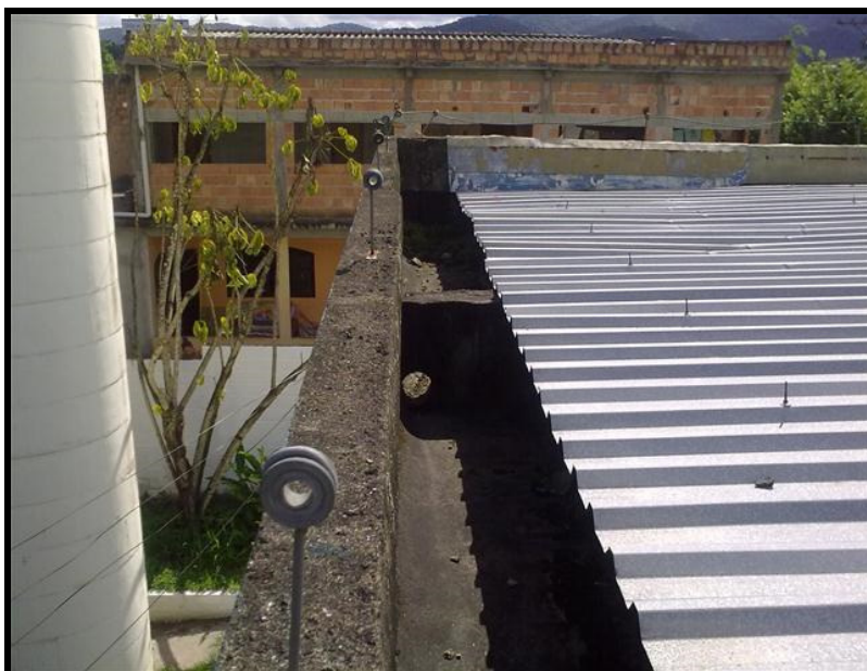
Figura 5 - Vista de uma viga-calha de platibanda com problemas de infiltrações
